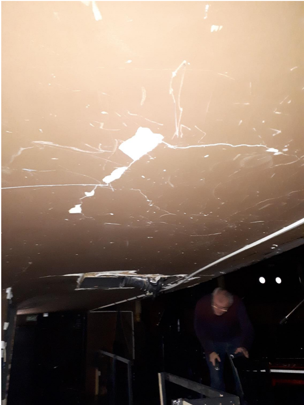
Otpala žbuka i pukotine ispod pozornice
